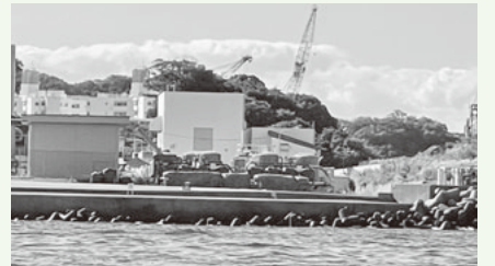
米海軍基地の粒状活性炭フィルタータンク
